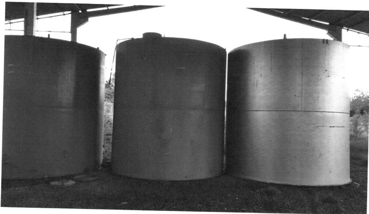
03 TANQUES, APARENTEMENTE EM AÇO
