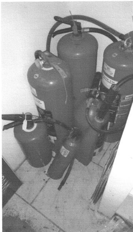
DIVERSOS EXTINTORES COM A CARGA VENCIDA OU A VENCER EM UM CURTO ESPAÇO DE TEMPO.
