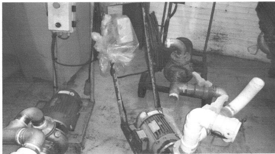
03 TRÊS MOTORES, TIPO BOMBA D' ÁGUA – SEM NÚMERO DE PATRIMONIO.
